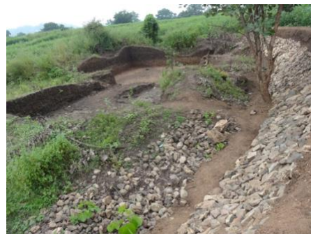
Fig. 8: Bassin de rétention des eaux pluviales
